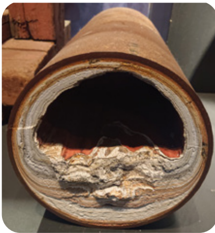
TUBERÍA CON INCRUSTACIONES (SARRO)
